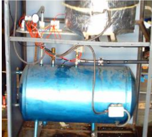
Εικόνα 24: Η μονάδα παραγωγής ατμού
